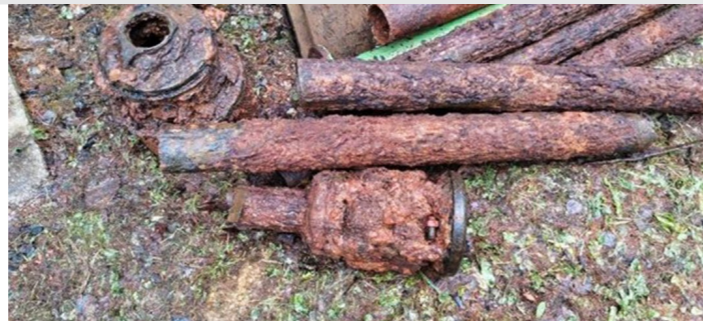
↑ Stávající vyměněná zkorodovaná technologie
